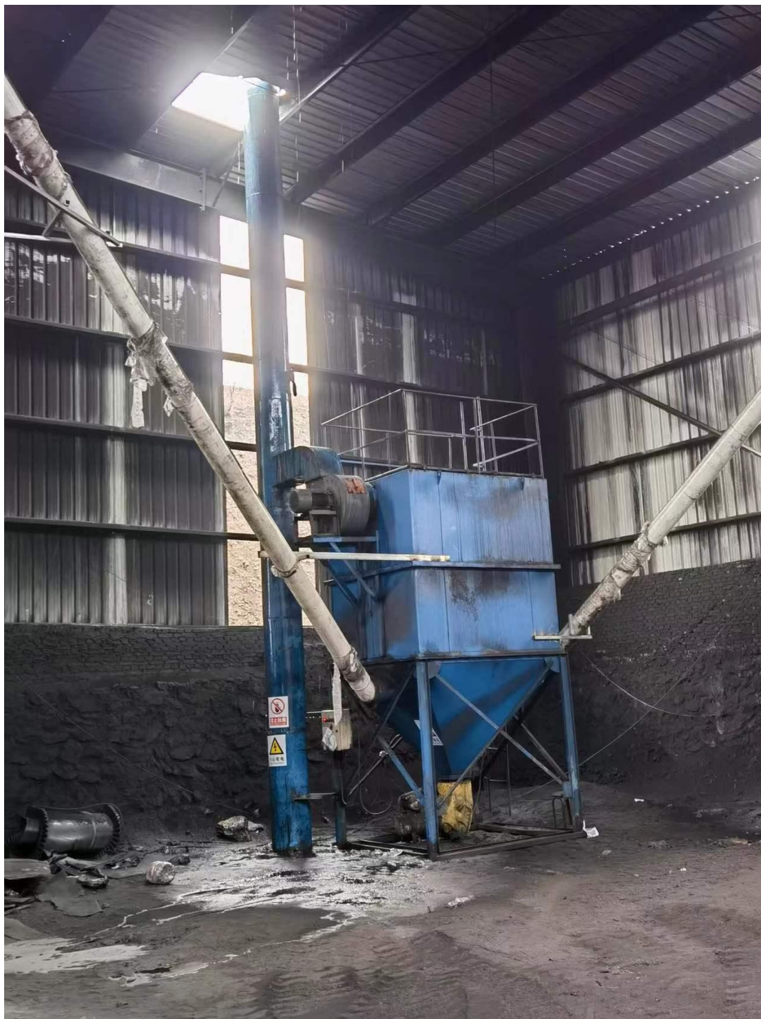
图 3-1 除尘器+排气筒
